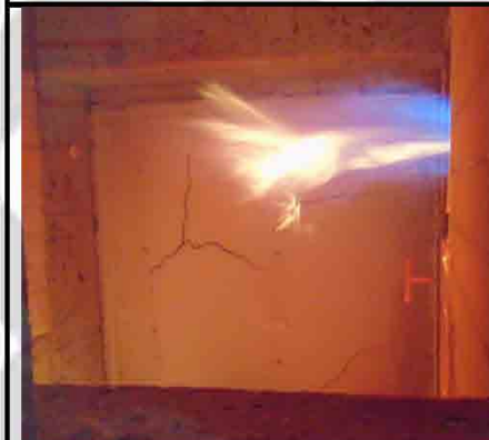
شکل ۵-۸: ترک خوردگی سطح در معرض آزمون (دقیقه ۱۷)
